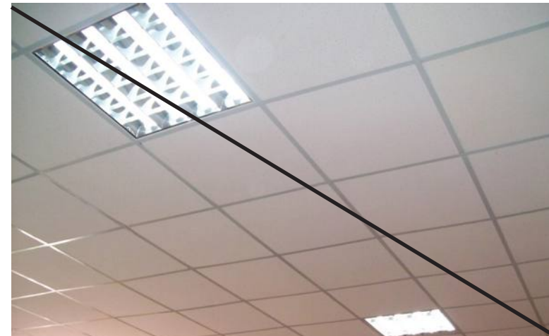
Плохо Открытые направляющие
